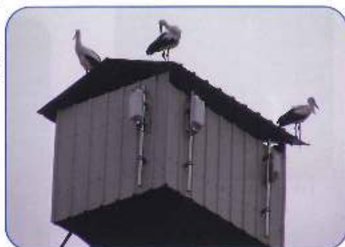
Bornes WIFI installées à la Richardière
