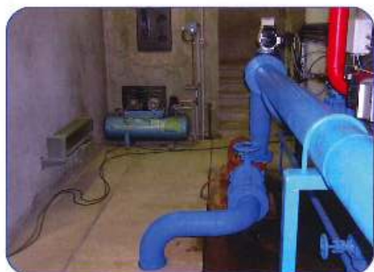
Compresseur et pompe de contre lavage
